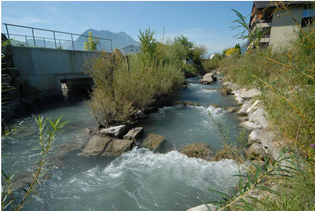
Abb. 3: Fischaufstieg Ambauenwehr Buochs
